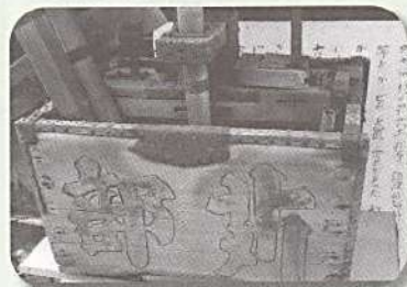
刈部宅ポンプ
